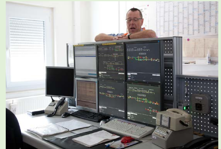
Elektronisches Stellwerk Altenstadt, welches das Wetteraunetz steuert
