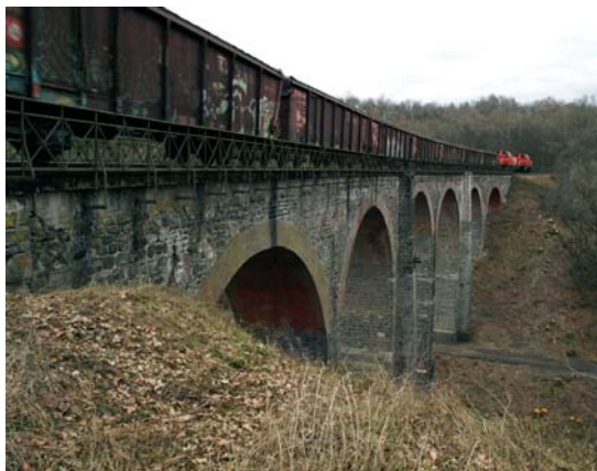
Die Hohe Brücke überspannt das Sandbachtal bei Niedererbach in bis zu 27 Metern Höhe. Seit 26 Jahren steht sie unter Denkmalschutz, dennoch wird die neue breitere Tragplatte die Optik verändern. Foto: Hans-Peter Günther
