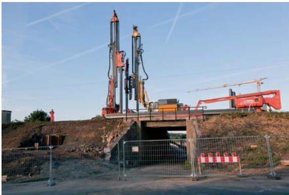
Die Brückenbaustellen in Langgöns (oben) und Großen Lindens (links) während der Sperrung. Mittels großer Rammen werden Spundwände ins Erdreich getrieben
