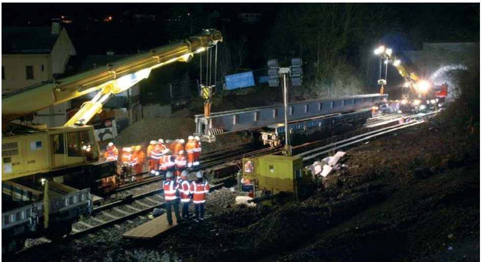
Einbau einer Hilfsbrücke im Stadtbereich Diez an der Lahntalbahn Foto: Hans-Peter Günther
