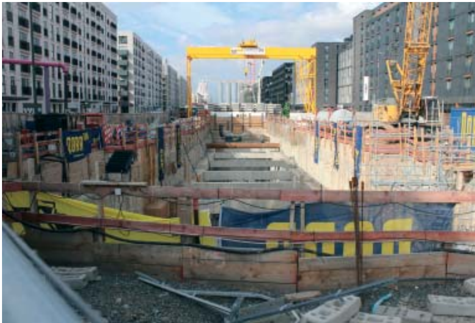
Mit einer Tunnelbohrmaschine wird der U-Bahn-Tunnel unter der Europaallee voran getrieben Foto: Friedrich Lang
