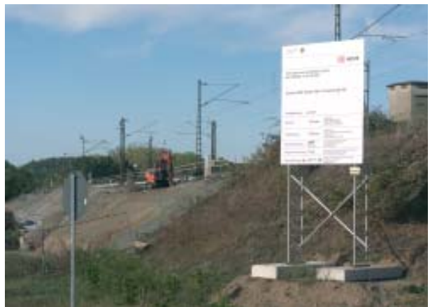
Der Bahndamm bei Großen Linden macht schon seit seinem Bau immer wieder Probleme
