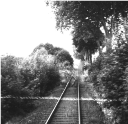
Die abgebaute Weichenzunge liegt im Gleisbett; das Gleis nach links Richtung Bergheim-Gifflitz kann nicht mehr befahren werden Foto: Jonathan Alt
