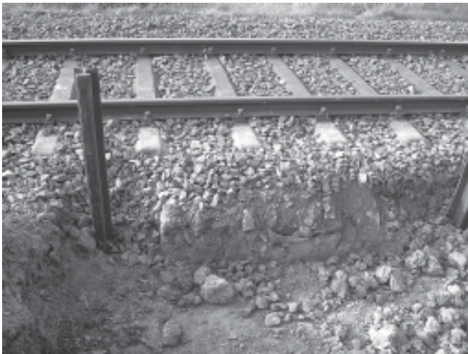
Bahnsteigbau in Mainzlar: Die Stahlprofile sind bereits eingerammt und werden anschließend mit Betonplatten verbunden, so dass die Bahnsteigkante entsteht
