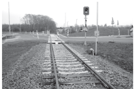
Der neue Kreisel wird vom Straßenverkehr schon halbseitig befahren. Bis auch die Züge wieder verkehren können, müssen noch Andreaskreuze und Ampeln installiert werden
