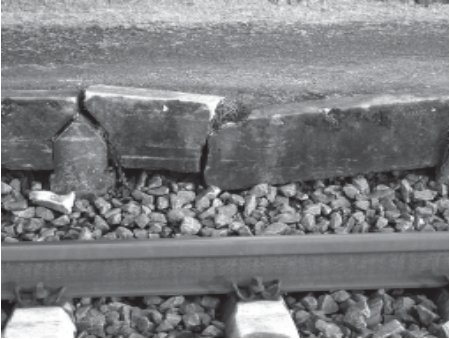
Gebrochene Bahnsteigkante am Haltepunkt Gettenau-Bingenheim
