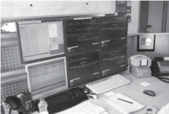
Vom neuen elektronischen Stellwerk am Bahnhof Altenstadt wird die gesamte Strecke gesteuert
