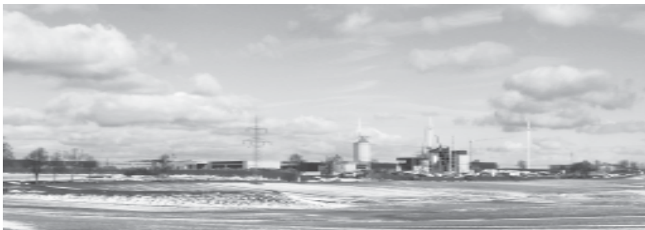
Ein neues Groß-Sägewerk entsteht bei Lauterbach-Wallenrod. Es erhält auch einen Gleisanschluss an die Vogelsbergbahn Foto: Stefan Sitzmann
