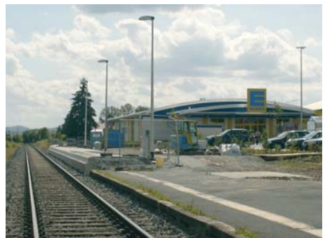
Alte und neue Bahnsteighälfte der Haltestelle Ernsthäuser am 30. Juli 2009. Im Hintergrund der neuen Edeka-Markt. Foto: Jürgen Schmied
