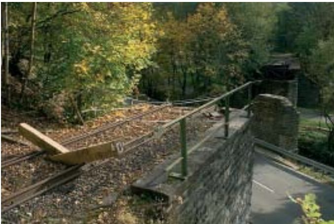
Der Blick vom Michelbacher Tunnel über die entfernten Brückenträger und den abgerissenen Pfeiler zeigt die Dimension des Schadens vom August 2009. Inwieweit es nach dem negativen Ausgang des Gutachtens zu einem Wiederaufbau kommen wird, ist derzeit sehr fraglich. Foto: Andreas Tscharn (12.10.2009)
