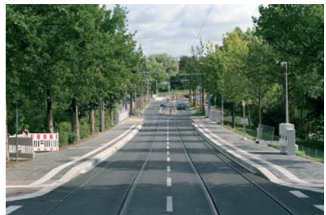
Die Arbeiten am Straßenplanum der Haltestelle Vellmar-Festplatz sind fast abgeschlossen Foto: Dr. Heribert Menzel
