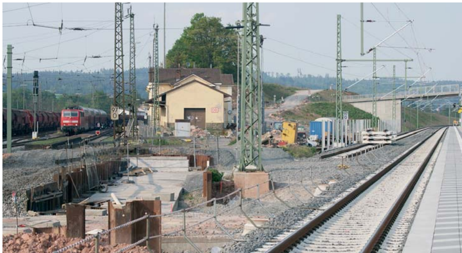
Alt und neu auf einem Bild; in der Bildmitte ist bereits der Zugang der Bahnsteigunterführung zum zukünftigen neuen Bahnsteig am Gleis 1 zu erkennen. Das neue durchgehende Hauptgleis Fulda – Frankfurt (Main) ist noch unterbrochen. 3 Fotos: PB&B Osthessen
