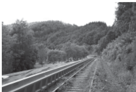
Die Bahnsteigkante des neuen Haltepunkts in Herzhausen ist bereits fertig gestellt. Der neue Haltepunkt liegt rund 500 Meter entfernt vom alten Bahnhof
